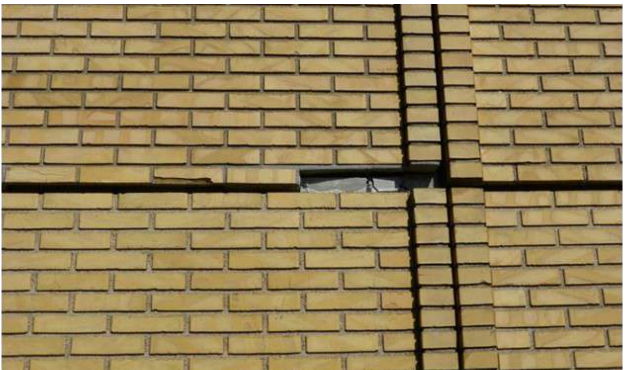
Gavl med teglskaller som er faldet ned.
