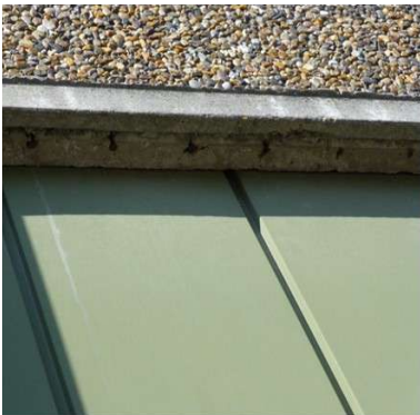
Korroderede armeringsender på betonbånd ud for etagedæk
