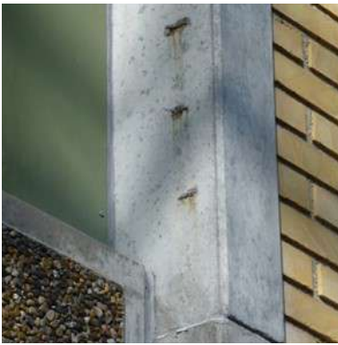
Korroderet armering på udragende tværvæg
